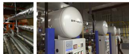
図 6 医療ガス機械室の様子
