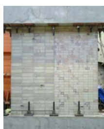
図 5-2 タイルの剥離状況 (1/200 終了後)
